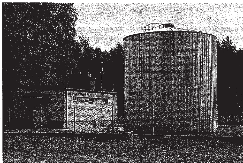
Rysunek 14. Stacja Uzdatniania Wody w Myszadłach
